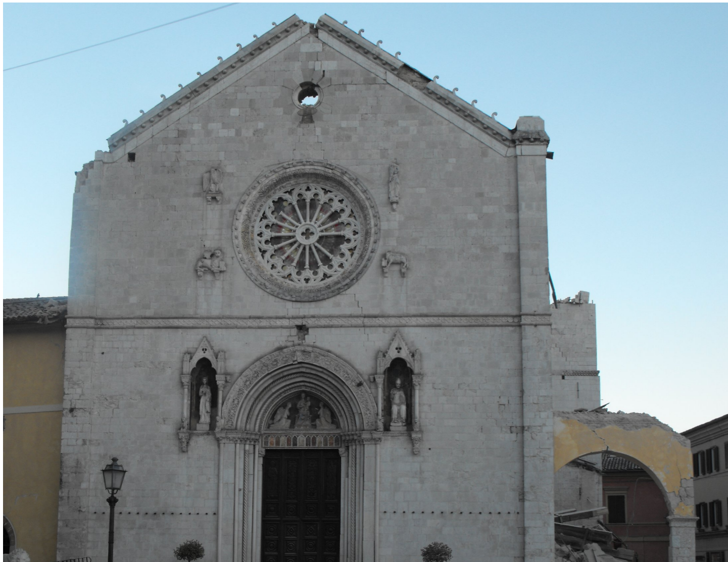
Norcia, basilica di San Benedetto (post sisma ottobre 2016)
